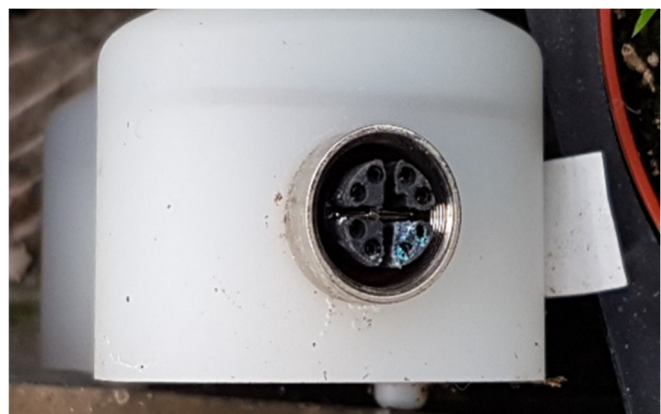
Abbildung 16: Korrosion am Connector durch Kondenswasser
